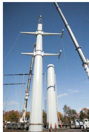
Übertragungsstation Monopole, Kanada
